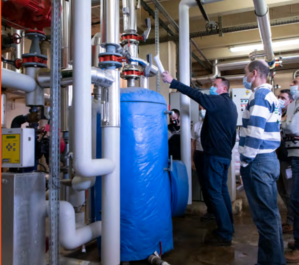
Formation prévention du risque infectieux lié à l'environnement, réseau eau chaude
